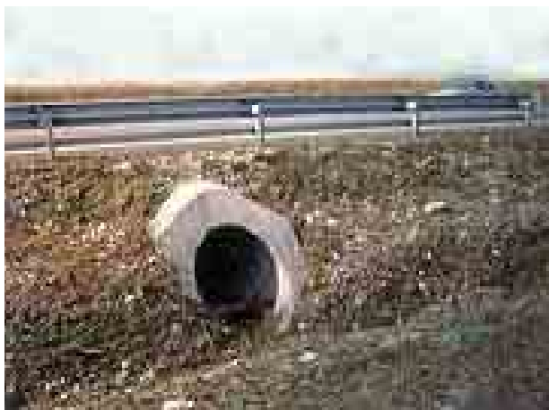
Fig. 5-1 - Esempio di sottopasso faunistico (non completamente funzionale) per piccola media fauna - Infra Eco Network Europe
