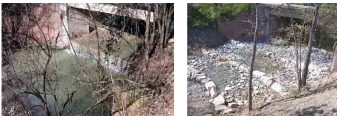
Fig. 3-3 - Esempio di costruzione di rampa in pietrame in Valsellustra (Pianificazione e realizzazione di metodi integrati per il recupero del bacino idrografico della Val Sellustra LIFE00 ENV/IT/000065 Comune di Dozza Newsletter n°6).
